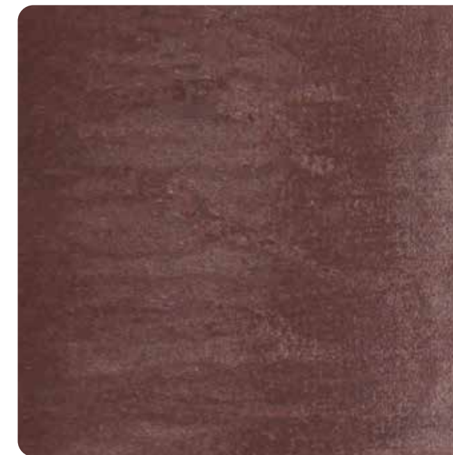
Температурные разводы без нарушения целостности облицовочного покрытия
